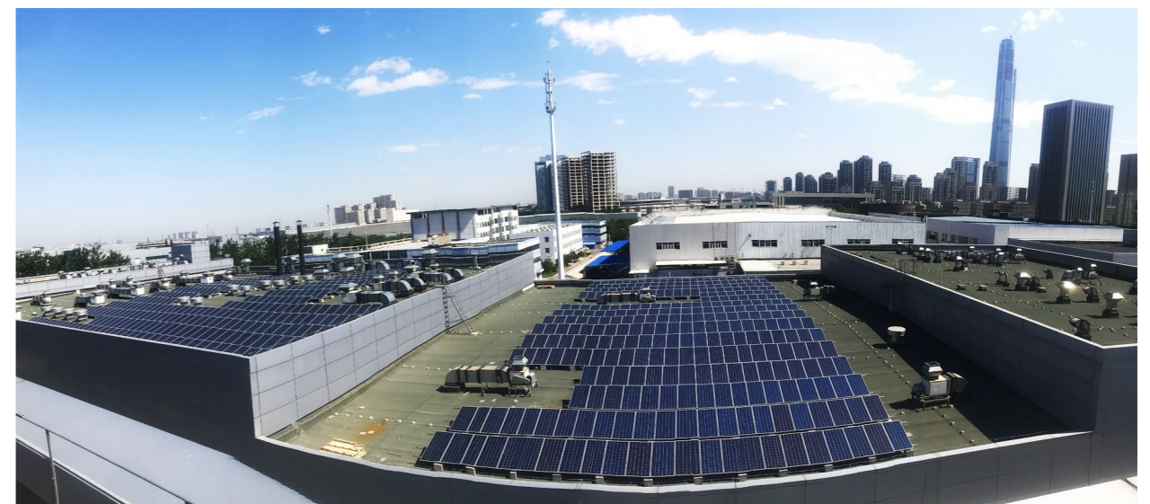
2021年8月，力神电池“六期屋顶分布式光伏发电”项目成功并网，项目采用“自发自用、余电上网”模式，持续推进节能减排和新能源建设
